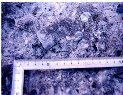
写真1 ブレーカー処理面に生じたひび割れ
