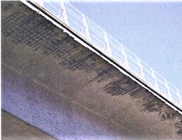
PC橋張出し部の損傷
