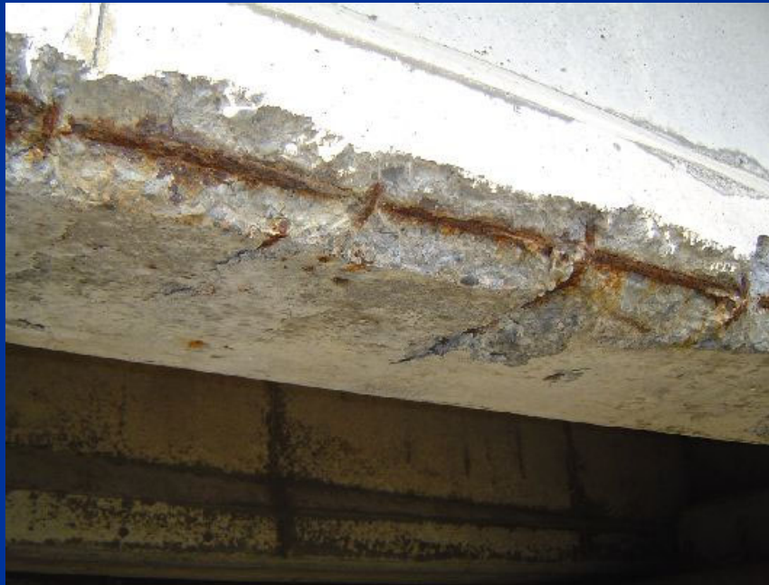
塩害による主桁の損傷部
