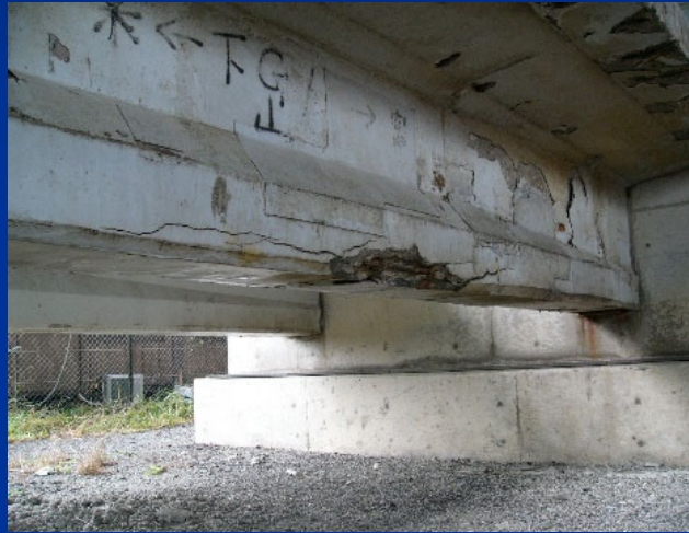
PC鋼材の破断
