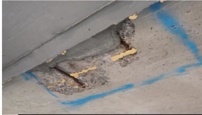
床版張出し部下面の変状
