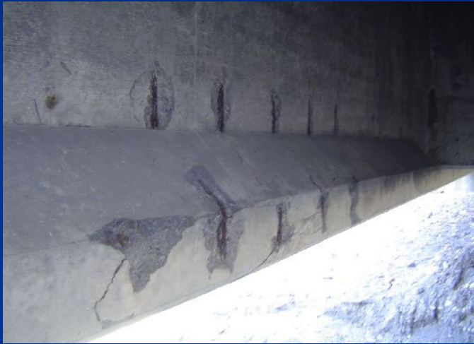
鋼材腐食とはく落
