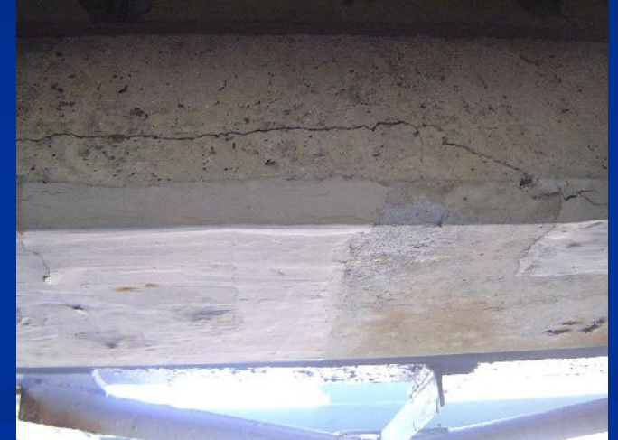
再損傷と撤去(更新)
