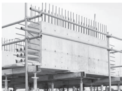
写真—1 空洞やジャンカを再現した実物大試験体
