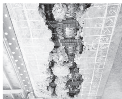
写真—2 試験体下面の空洞
