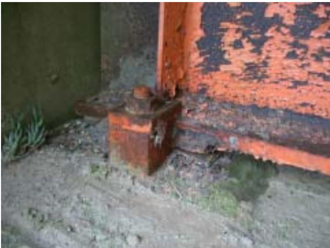
写真3 橋梁端部支承部の土砂の堆積
