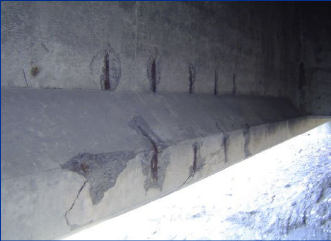
鋼材腐食とはく落
