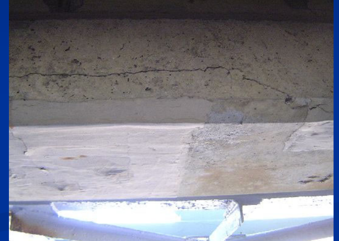
再損傷と撤去(更新)
