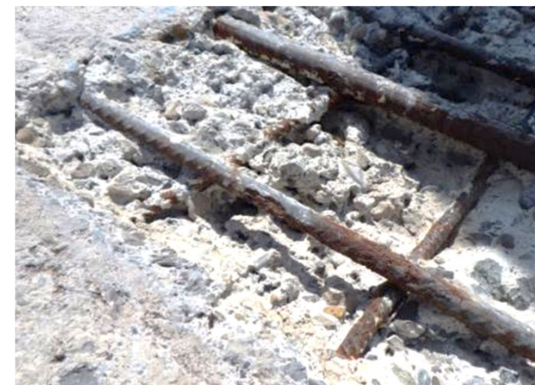
マクロセル腐食
