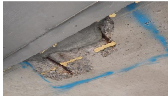
床版張出し部下面の損傷
