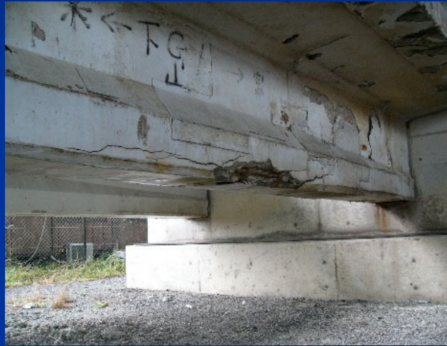
PC鋼材の破断
